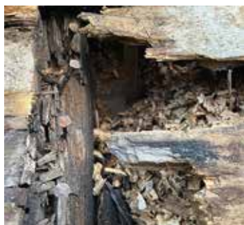
Det är bland annat ruttna takstolar som fördröjer öppningen av Skogsö kapell.
