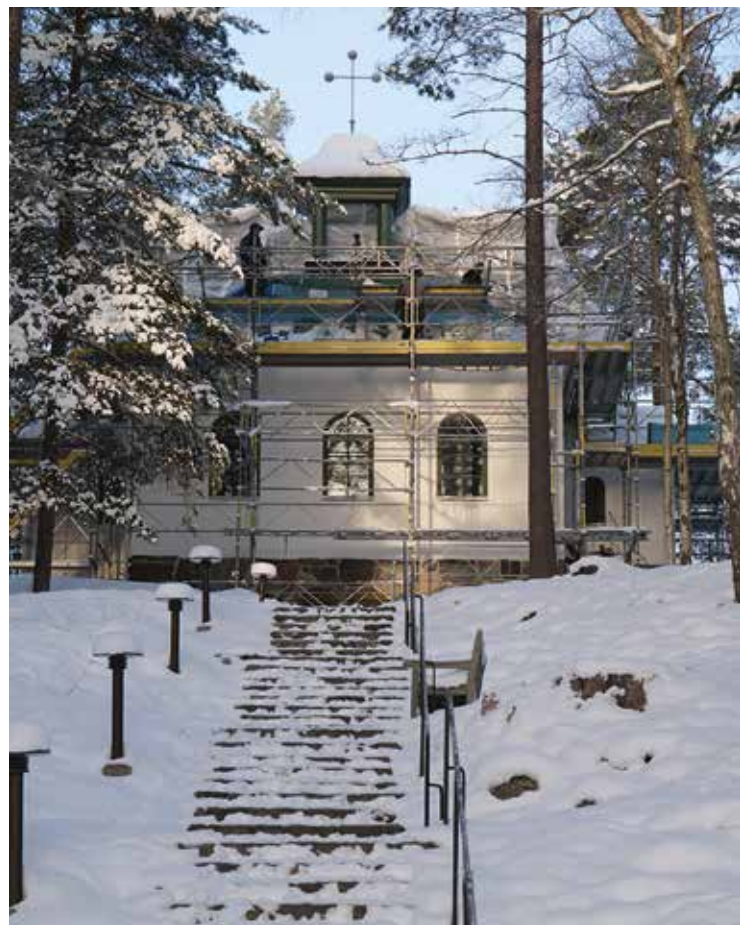
Öppningen av kapellet på Skogsö dröjer då det vid renovering uppbyggades röta i konstruktionen. Idag finns inget nytt datum för när kapellet kan börja användas igen.
