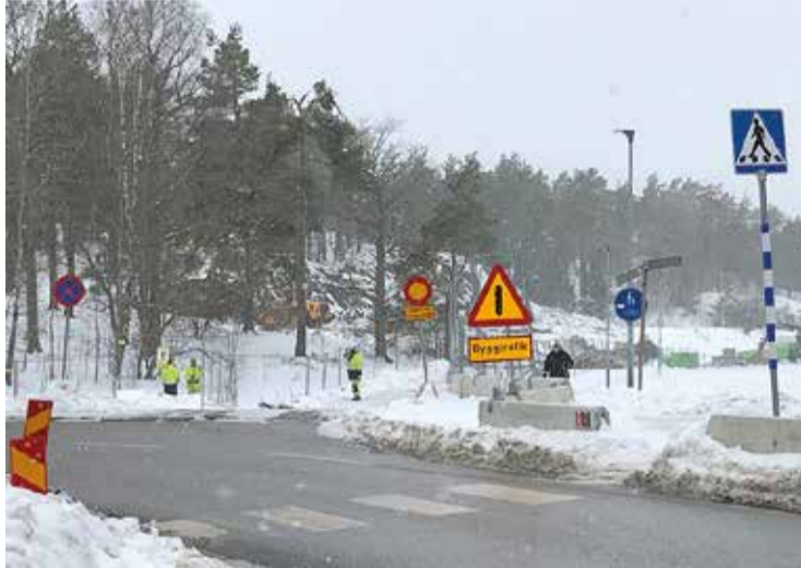
Gångtunneln under spåret kommer att vara stängd under hela byggtiden. Foto: Marie-Louise Gravestam
