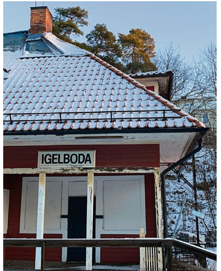
Det eldhärjade stationshuset har stått skadat och tomt sedan 2013. Många röster har höjts under åren för att rädda byggnaden, bland annat har 4000 namnunderskrifter samlats in. Nu ålägger kommunen ägaren SL som nekats rivningslov att åtgärda den skadade byggnaden. Annars väntar viten på stora belopp. Foto: Johan Eriksson
